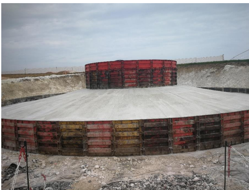
Figure 19 : Photographie d'une fondation d'éolienne
