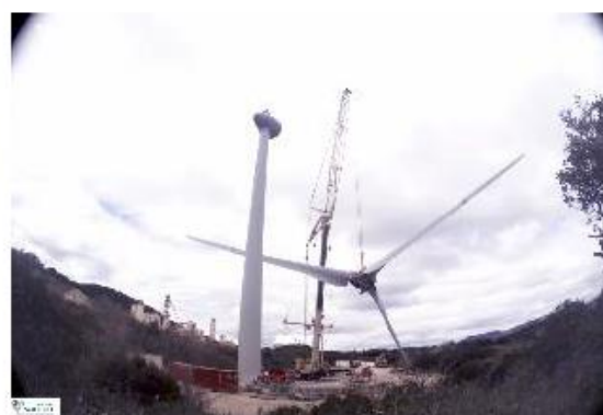
S'agissant d'un repowering (remplacement de l'éolienne par une plus performante), montage du rotor de la nouvelle éolienne.
